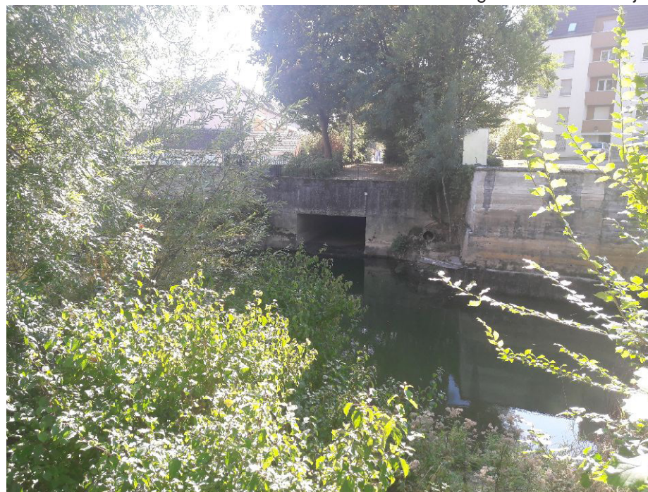
Déversoir d'orages rue de l'Île - Dijon
