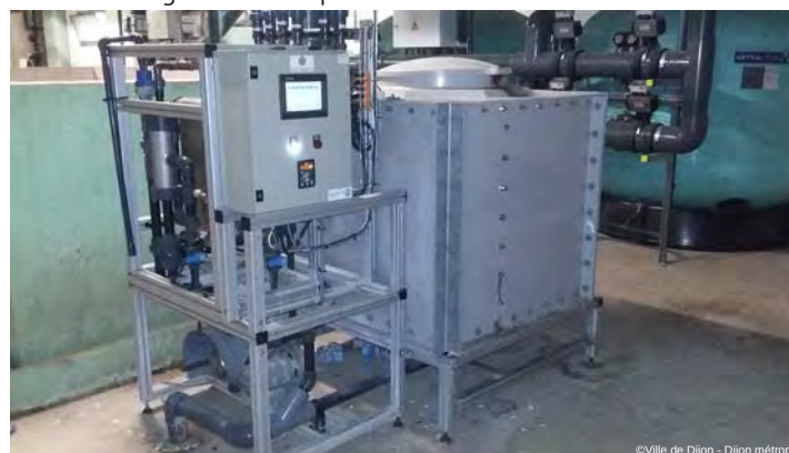
Gestion du degré bleu : Pompe à chaleur
