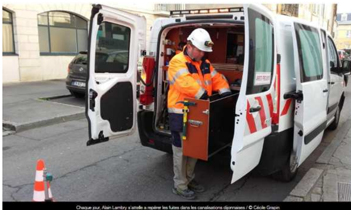
Chaque jour, Alain Lambray s'attelle à repérer les fuites dans les canalisations dijonnaises / © Cécile Grapin
