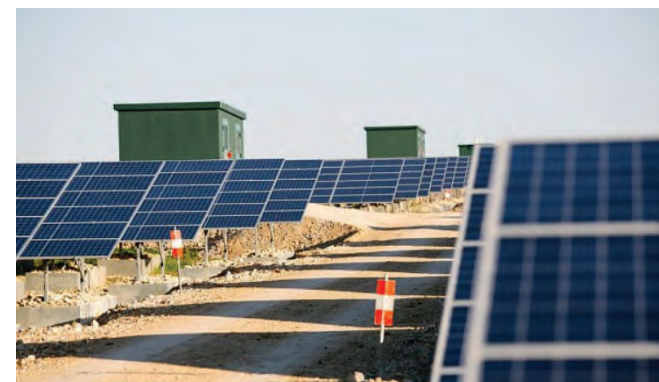
Centrale solaire de Dijon - Valmy © EDF
