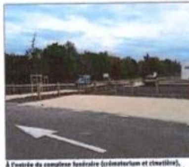
À l'entrée du complexe funéraire (crématorium et cimetière), un parking a été aménagé au printemps, portant à 250 le nombre de places de stationnement sur le site. Photo LAFIX, D.
