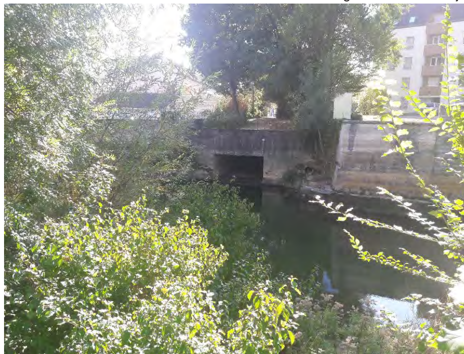
Déversoir d'orages rue de l'Île - Dijon
