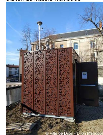
Station de mesure Trémouille
