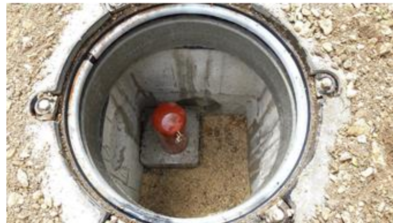
Piézomètre dans un puits de captage
