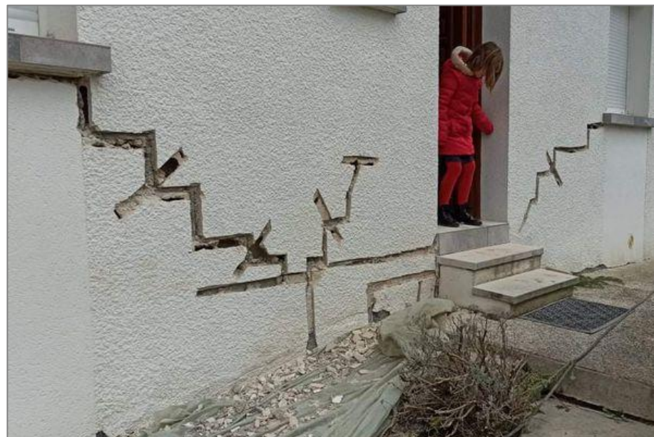
La façade d'une maison touchée par un retrait-gonflement des argiles, suite à la sécheresse de 2018
