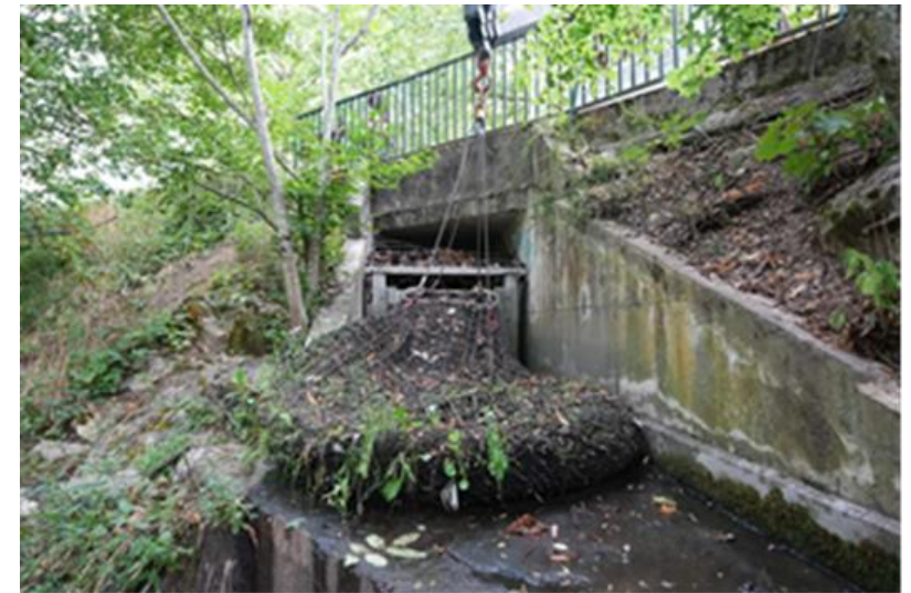
Filets de piégeage installé sur un exutoire
