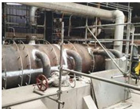
Contrôle décennal par ressuage du ballon de la chaudière n°2
