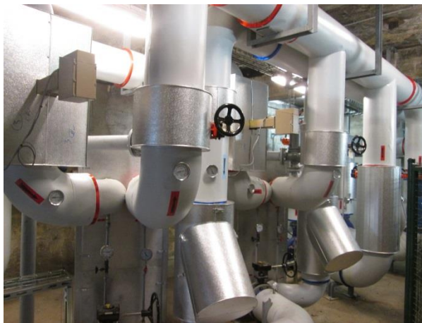
Sous station CHU Bocage : 2 échangeurs de 8 MW
