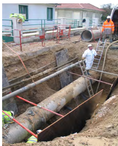
Février 2009 - réparation d'une fuite à Plombières-lès-Dijon sur la conduite en provenance de la ressource de Morcuell
